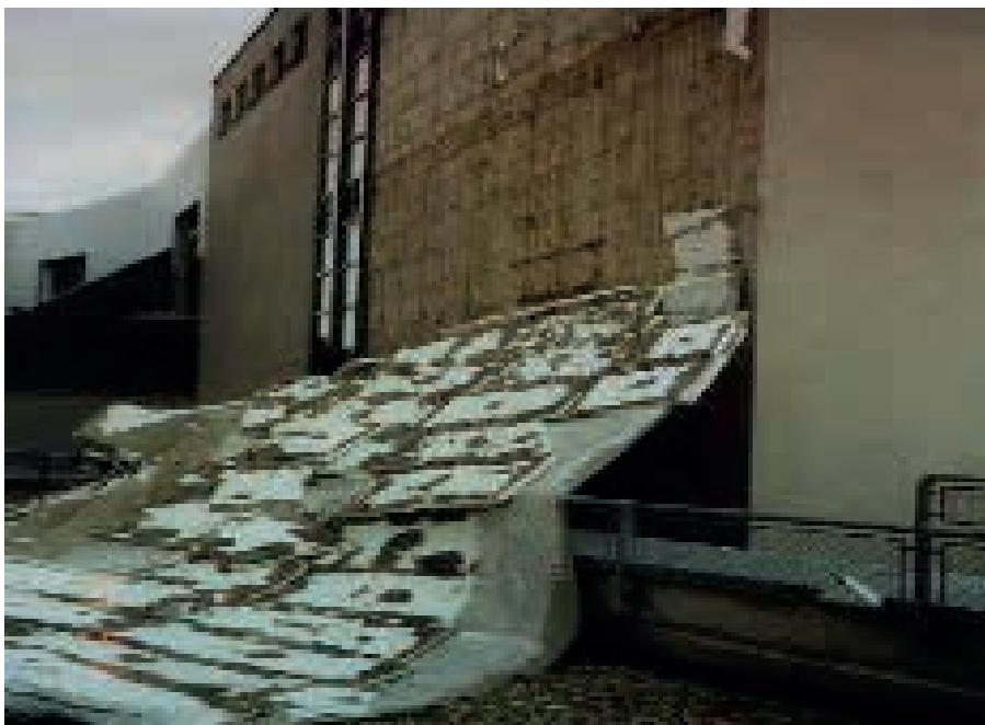
Fotografia 4 - Falha na estabilidade
